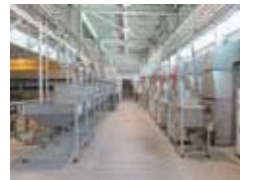
材料乾燥設備・集中輸送装置
